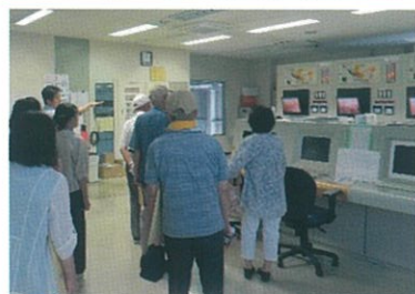
焼却施設の中央制御室
