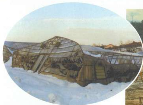
大雪によるビニールハウスの倒壊 （昭和55年12月）
