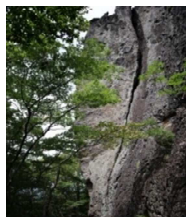
賞仙洞の岩の亀裂
