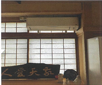
談話室にエアコン設置
