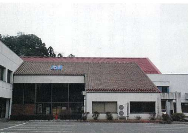
瓦が落ちた屋根に応急措置
