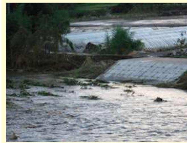
大関間野地内、護岸工事されていない部分があと少しで完全に壊れるところでした。
