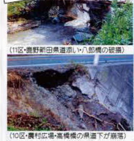
(11区・鹿野新田農道流し八部橋の破損)
